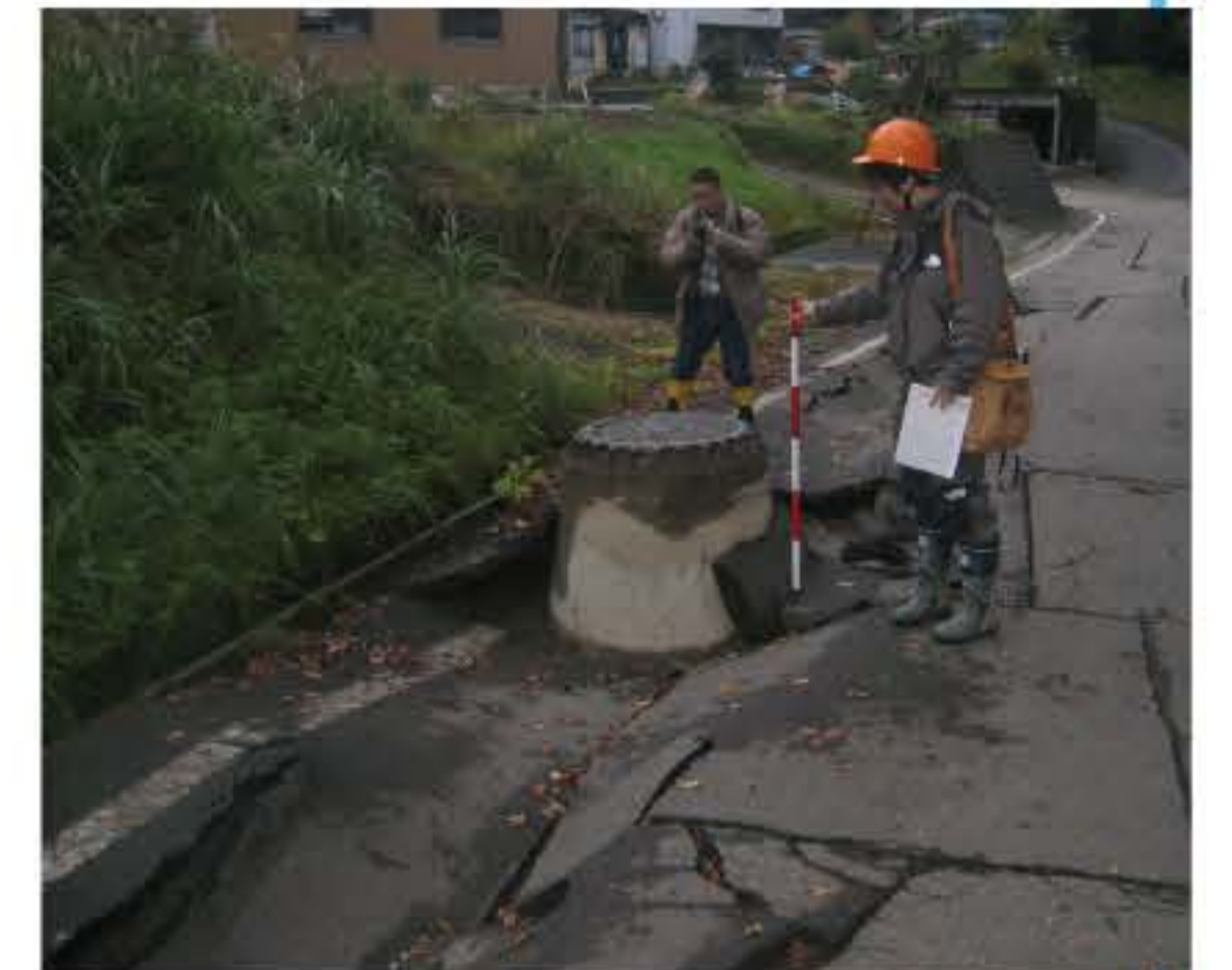
マンホールの浮き上がり (2004年中越地震：新潟県魚沼市)
