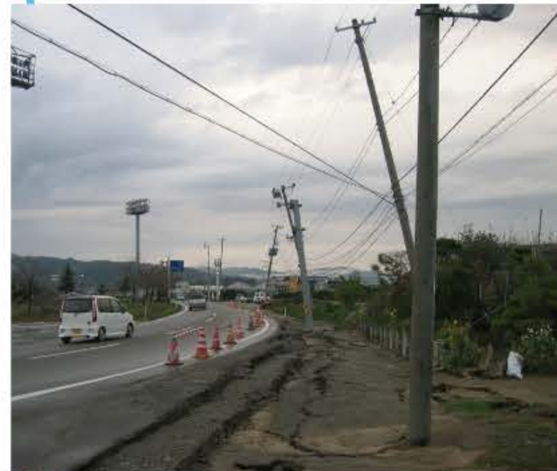
地盤の側方流動に伴う亀裂と電柱の傾き (2004年中越地震：新潟県長岡市)
