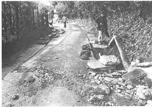
1. 断層の右横ずれ変位に伴う圧縮によって生じたコンクリート路盤の pressure-ridge. 断層は画面右手前より左手奥へ通過する (Loc. 26)
