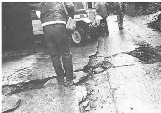
2. 重なり合ったコンクリート路盤 (Loc. 20). 断層は画面の左側から右側へ通過する Overlapped concrete slab at Loc. 21. Fault trace runs from the left side to the right side of the picture.
