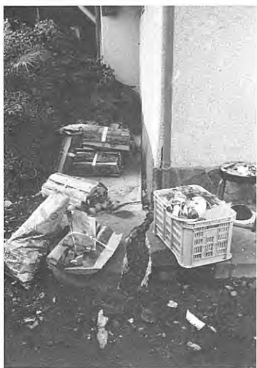
1. 断層が通過したため破壊した民家の土台 (Loc. 20) Damaged foundation of the house at Loc. 20.
