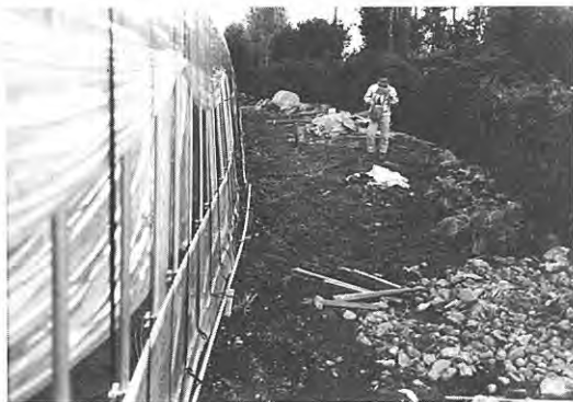
3. 断層運動のため変形したビニールハウスの側面。人物の足元には、雁行状に配列した小亀裂群が見える (Loc. 37). Deformed wall of the greenhouse at Loc 37.
