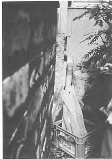
3. せん断亀裂のために変位したコンクリート・ブロックの塀 (Loc. 5) Offset of the concrete block masonry fence by the shear fracture at Loc. 5.
