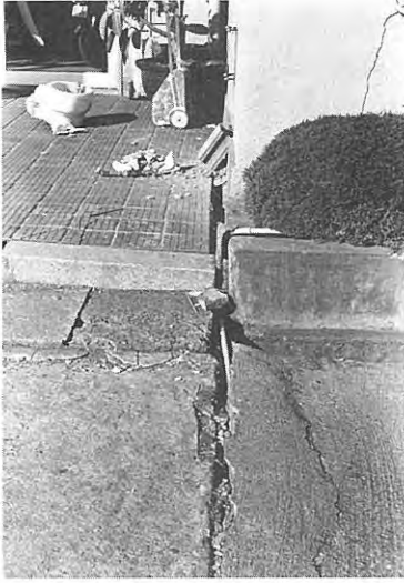
1. 断層運動のために破壊された稲取中学校校舎 (Loc. 10) The Inatori Junior High School deformed by faulting at Loc. 10.
