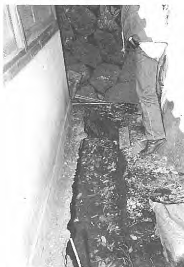
2. 断層運動で移動した納屋の土台. この土台は, 元は人物の足元にある板の所に位置していた. 断層は画面の一番下を左上から右下に通過している (Loc. 28) Deformed foundation of the barn at Loc. 28.
