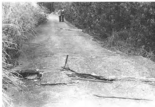
3. 断層の右横ずれ変位に伴う圧縮で破壊されたコンクリート路盤. 断層は画面上半部を右下より左上に通過 (Loc. 53)
