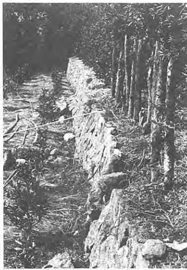
2. ほぼ平行する2本の亀裂帯のため、一連の石垣が2カ所で変位している (Loc. 41) Two fractures splitted the stone wall at Loc. 41.
