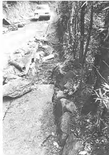
2. 道路脇の石垣に認められた右横ずれ変位 (Loc. 26)
