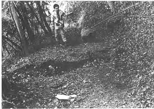
2. 林道を横断する亀裂 (Loc. 33) Surface fractures on the road at Loc. 33.
