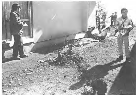
5. Loc. 28 で民家の土台を破壊した亀裂
