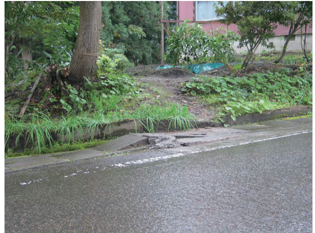
写真2. 同左。道路側溝のコンクリートの蓋板が圧縮され、盛り上がっている。写真撮影時(26日午後3時頃)の計測では、圧縮により盛り上がった側溝の高さは約12cmであったが、28日午後3時頃の計測ではその高さは約13cmと大きくなっていた。付近の人の話によると、本震のあった翌日の24日朝には道路にわずかな隆起が見られ、その後、大きな余震の度に次第に成長したものらしい。
