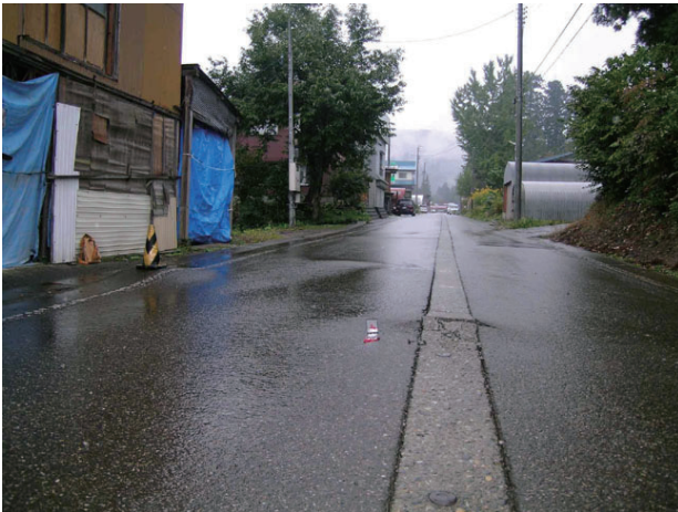
写真1. 小平尾集落北部の旧国道352号線上にみられる地変(10月26日午後撮影)。道路中央に埋設されて破壊され、盛り上がっている消雪パイプ。数cm程度の水平短縮が生じたものと思われる。
