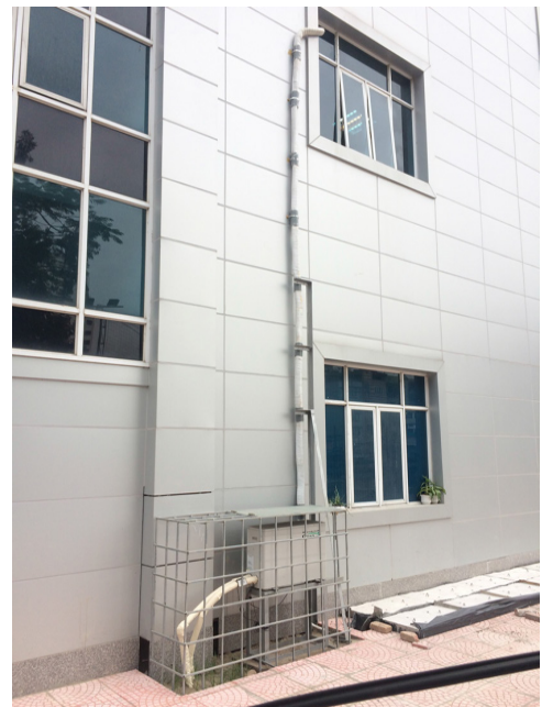
写真5 1階に設置した地中熱ヒートポンプ。雨期に洪水が発生しても水浸しないように, 50cm 程度かさ上げをして設置している。
