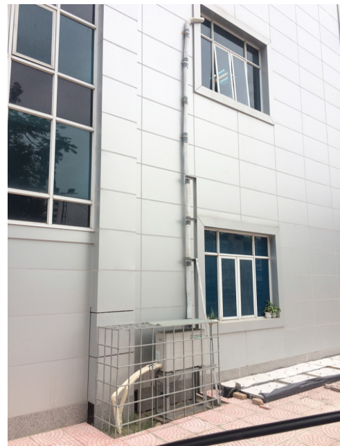
写真5 1階に設置した地中熱ヒートポンプ。雨期に洪水が発生しても水浸しないように, 50cm 程度かさ上げをして設置している。
