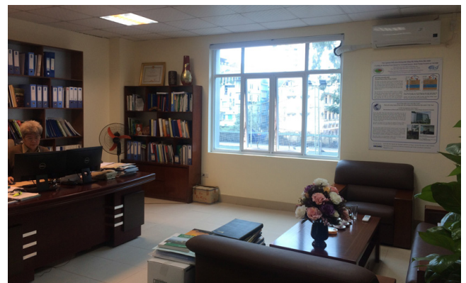
写真6 2階所長室に設置した地中熱室内機。室内機の下にプロジェクト紹介のポスターを掲示。
