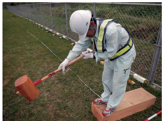
写真1 掛矢を用いた板叩きによるS波発震作業の様子。この探査では2人が板にのって荷重を加えて発震したが、撮影のためにこの写真では1人しかのっていない。
