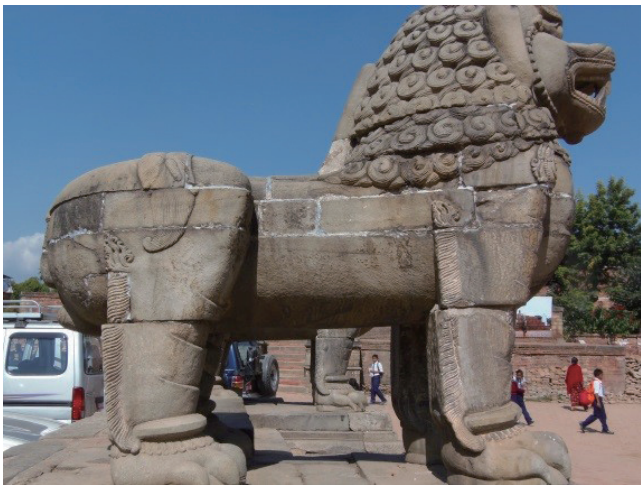
第 15 図 「獅子門」の石像。石塊の継ぎ目は白く補修されているが、脚部と胴体部のずれは修復されていない。
