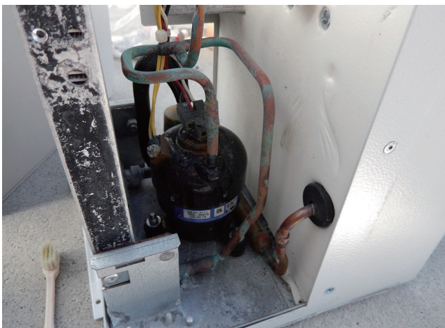
第8図 塩害腐食を受けた空調機。塩害腐食に強い素材の空調機と交換し、さらに外箱で覆った。
