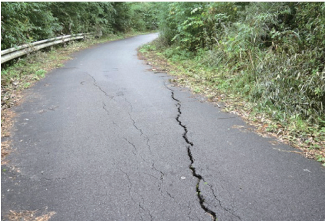
写真1 余震分布域を横切る測線上(地点1:円谷町-岩倉間の舗装道路)で観察された開口亀裂。斜面下方側が落ちる重力性の亀裂と解釈した。
