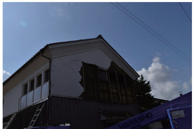
写真4 倉吉市内の白壁土蔵(地点3)にみられた壁材の崩落。調査範囲内のその他の土蔵では、これほどの被害は認められなかった。
