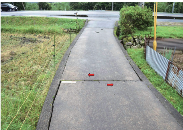
写真2 本震の震央付近(地点2:恩鳥)で観察された左横ずれもしくは回転による移動を示すコンクリート道路接合部の開口。周辺への延長が認められないため、地表地震断層を示すものではないと判断した。
