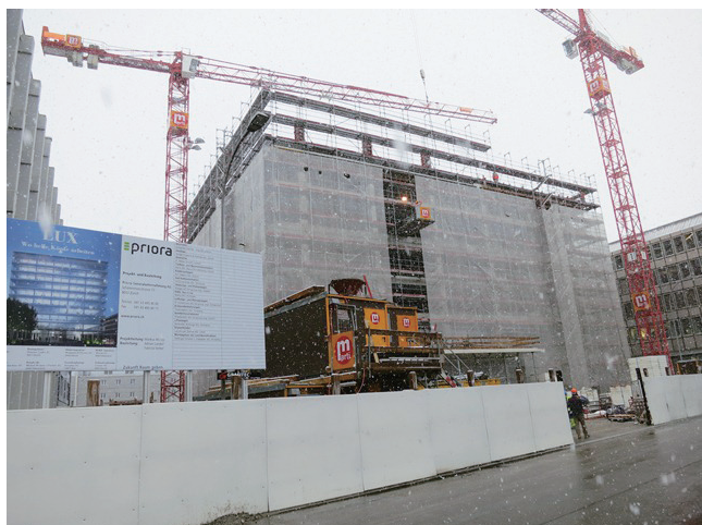
写真2 GHPを導入する大型ビルディングの工事現場。オフィスとして使用される。
