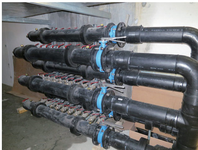
写真3 写真2のビルディングの地下に設置されたGHPシステムの配管の一部。30本のBHEから集められた循環液がここで一つにまとめられ、ヒートポンプへ送られる。
