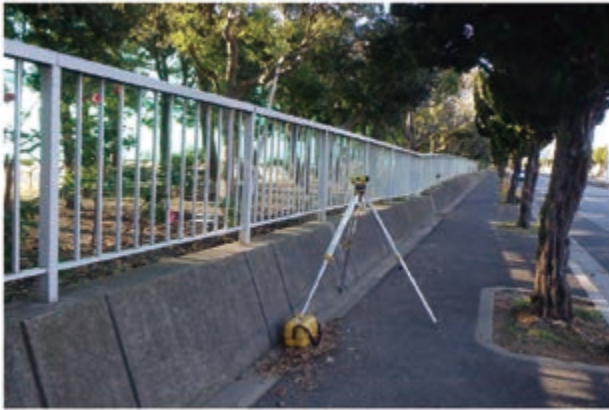
第3図 調査地点近傍の擁壁。 高校敷地の北東縁には道路に沿って緑地があり、 これと道路の境にある擁壁が局所的に沈下した。
