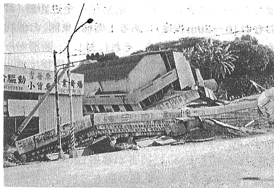
写真7 草屯東の地震断層崖上の家屋の倒壊 (太田撮影).
