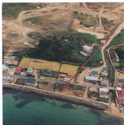
写真80-4 河野 道信氏邸北および東方の掘削状況を西方海上から撮影した斜め空中写真 [マップシステムカンパニー撮影(1987.10)].
