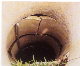
写真90 掘り井戸内の円形コンクリート型枠の弧形変形破断[服部撮影(1997.5.18)].
