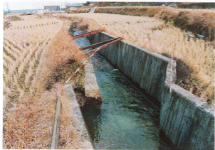
写真85-2 約9mのコンクリート水路区間が20cm浮き上がる。南端が50cm東方にずれて直線距離で約105cmの隙間ができた。7m地点を上流側から見る[水野清秀氏撮影(1995.1.27)].
