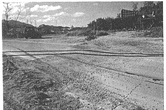
写真48-4 同場所の破壊されたアスファルト路面の亀裂と段差。南側(写真向かって左)がごくわずかに高く見える。幅約2mで盛り上がった路面が応急工事によって砂利で埋められ、本震の翌日午前中には通行できるように修復された[水野清秀氏撮影(1995.1.27)]。
