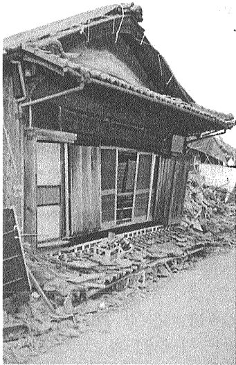
写真60 井手本酒店の倒壊(第21図)。屋根瓦がそのまま残存し、一階部分が座屈して潰れた[井手本昌郎氏撮影(1995.1.21)]。
