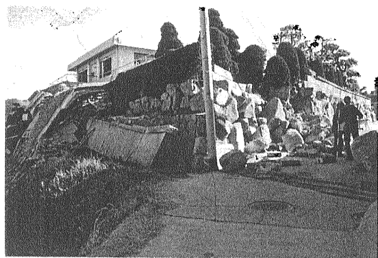
写真57-7 同氏邸西隅の小道交差点における外塀とコンクリート路面の被災状況 (第19図E地点) [水野清秀氏撮影 (1995.1.19)].
