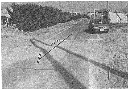
写真48-2 同場所において砂利埋めにより仮修復された後の断層部分。水道管理設位置(太い実線)と破断・分離状況(細い二本線)を記入。写真48-1とは反対方向から撮影[川崎満男氏撮影(1995.1.18)]。
