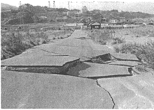
写真49-4 農道におけるアスファルト路面の大破断状況(第15図B4地点). 左側の路面下に水道管が埋設されており, 破断して大出水した[川崎満男氏撮影(1995.1.18)].
