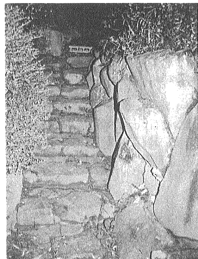
写真58-6 墓所下の小道からの入り口。雨水溝をまたいで8段の石階段を約1.5m登る。角地の側壁はごつい石積み擁壁からなる。石などがはらみ出して小道が狭くなった(第20図の位置6) [服部撮影(1998.10.24)].
