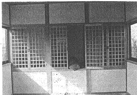
写真50-5 お堂のなかの変状 (第15図C4地点) [服部撮影 (1995.1.28)].
