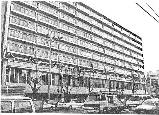
写真25 下層部が量販店で、上層部が集合住宅となっており、その境界部の層が崩壊。
