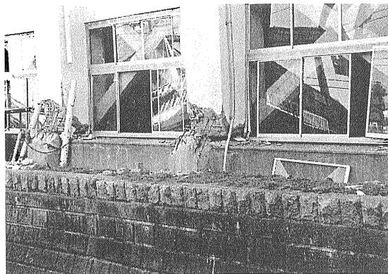
写真22 1階柱脚部のアンカープレートが滑りだして破壊.
