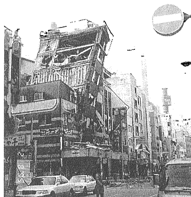
写真11 鉄骨造7階建て建物の全層崩壊。ブレース破断による強度低下。
