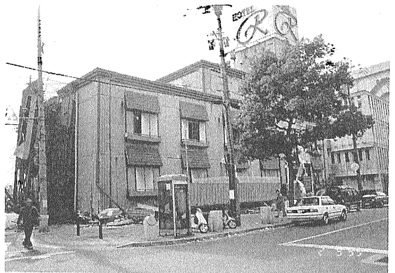
写真5 長田区にある軽量鉄骨造の3階建てホテルの1階が崩壊していた。
