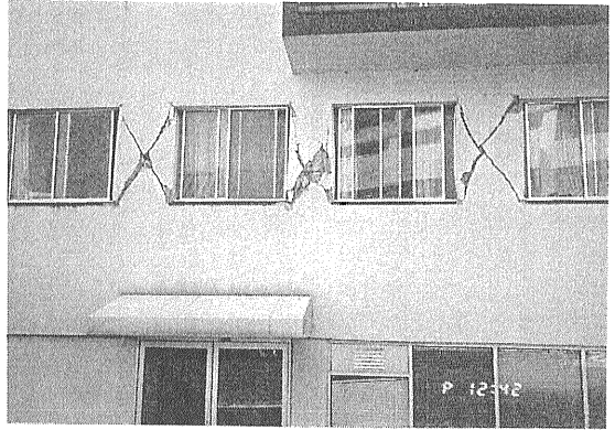
写真26 雑壁と柱に X 状のせん断ひびわれが生じていた。
