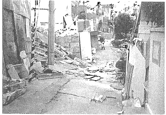
写真1 会下山付近の地すべりによる被害。写真中央の路地は、本来直線であったものが右方に湾曲している。周辺の家屋には、基礎部分に段差が生じたり、建物全体が傾くといった被害が出ている。
