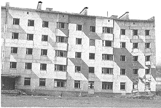
写真12 デュカート開発基地, Omsukchan のアパート。 永久凍土が溶けて建物が歪み, 使用不能となる。
