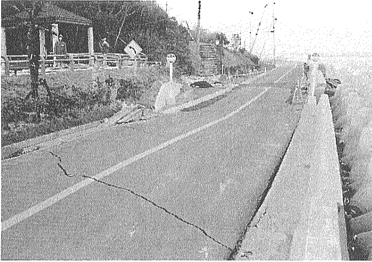
写真1 江崎灯台付近の道路から南西を見る。道路に緩やかな段差、道路左の路肩に圧縮変形が見られる(1月28日)。
