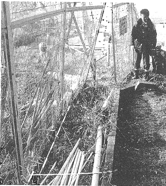
写真2 金網フェンスの0.9 m 右横ずれ(1月20日)。
