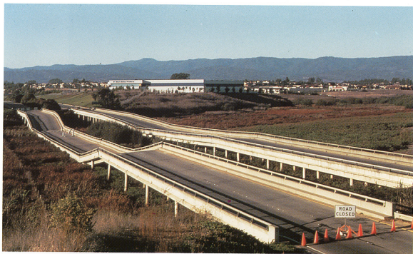
1. ワトソンビル市南西部 Struve Slough橋の被害。カリフォルニア州の太平洋岸に沿って走る幹線道路1号線は、この地点(震央の南約20km)で河川地植物などからなる湿地帯を通過する。軟弱な地盤の強い震動により、橋の中央部が約100mにわたって崩落、橋脚の一部は橋の床を貫いた。(写真提供: USGS)
