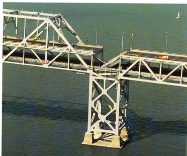
2. サンフランシスコとオークランドを結ぶベイブリッジ(1936年完成)では、橋脚とトラス桁との連絡ボルトが切断し、上層道路桁が落下した。右がオークランド側。(写真提供: USGS)
