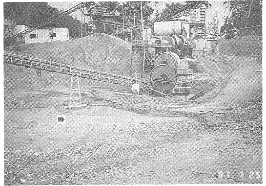
写真2 圧縮クラックとプレッシャーリッジ 道路を横断している(1987.7). 矢印は地すべりの移動方向(向斜軸に直交).
