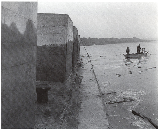
写真5 岸壁のブロックに残された最高水位の痕跡：ブロックに残された痕跡から最高水位は、岸壁の天端から約1mの高さまで達したことが、はっきり読み取れます。もしこの時この地点に人が立っていたら、津波の「引き波」にさらわれてしまったことも十分考えられます。
