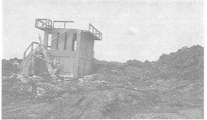
写真-1 A火口の北西約600m地点の展望台（1月11日，土谷撮影）。溶岩に埋没せず残ったが，A火口からの火山弾により手すりや階段壁の一部が破壊された。おそらく11月20日か21日の噴火によるものであろう。右側は新しい溶岩流。
