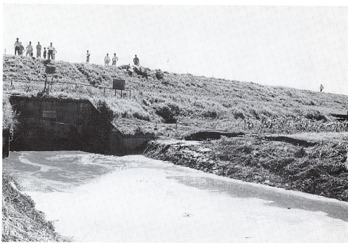
写真-4 堤内地の豊田自然種管南側脇の漏水はますます大きくなっていきます。堤防上では消防団員などが不安気にそれを見守っていますがどうすることもできません。
