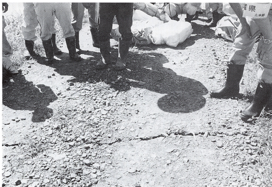
写真-3 9時10分頃 不気味な亀裂が堤防上を横切っているのが発見されました。
