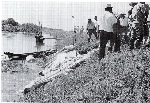
写真-2 9時頃 6日朝7時50分頃漏水が発見された豊田機場地先では消防団員等によって 土嚢の投げ込みや登・シート張りによる懸命の水防作業が行われています。
