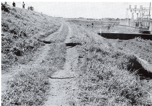
写真-7 9時40分過ぎ 堤防下の道路にはっきりとした2本の亀裂が現れ その間の土塊は堤内地側へズリ下がってきました。
