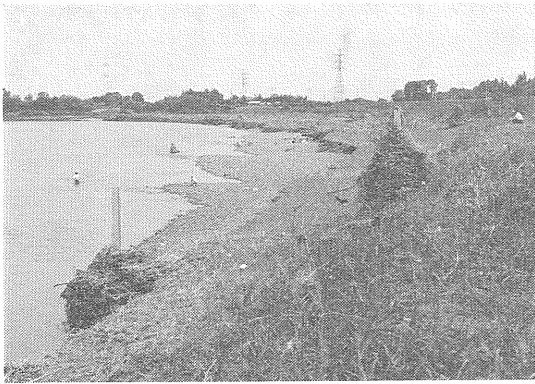
写真 5 千代橋右岸の浸食。下流方向を望む。
