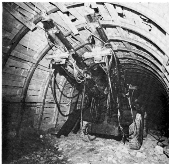
写真2 坑道とジャンボ 坑道掘削や鉛石採掘にはジャンボと呼ばれる大型のさく岩機が使用されている。火薬をこめる穴を手作業であけていた頃にくらべると 1回の発破で崩される岩石や鉛石の量は桁違いに多い。
