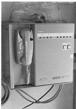
写真5 観測データの送信装置(子局)。各観測小屋に1台ずつ設置されている。専用電話で親局と交信できる。
