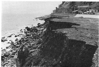
写真5 急速に侵食された“陸地”の海側 (5・6とも1978年3月撮影)
