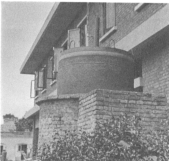
写真18 ホテルの調理用ガスを採集するセパレーター (NPC-10) カトマンズ市中央部 マラホテルにて
