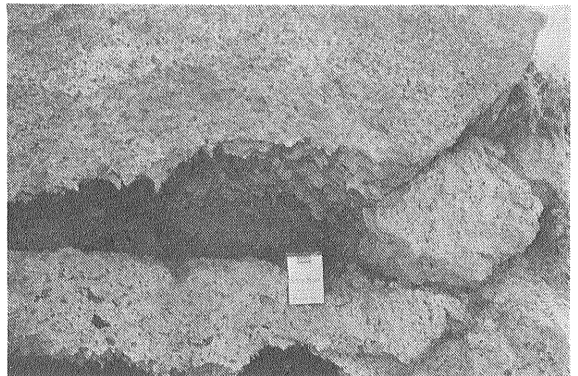
写真-5 写真4の拡大 上部及び下部の空洞の境界部 空洞周辺には気泡が特多い
