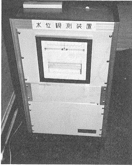
写真6 中浅測器製 水位観測装置 (相良水位観 測井)
