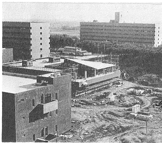
図 26 厚生センター 工事中の厚生センター 食堂 売店 理容室 美容室が 設置される
