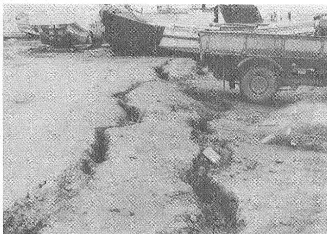
写真8 霧多布港の埋め立て部分に見られた地割れ
