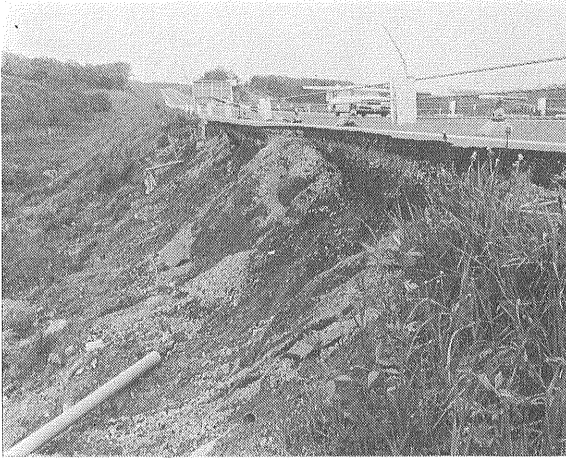
写真1 路肩の崩壊 低地を埋めた部分で崩壊を起している (別当賀橋西)
