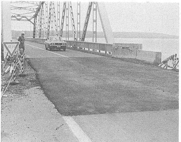
写真4 温根沼大橋西側 別当賀橋と同様の沈下で 一時交通止めとなった (別当賀橋)
