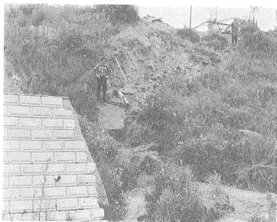
写真9 釧路市緑ヶ丘の宅地造成地での崩壊 末端処理が不十分であった所が崩れかけている
