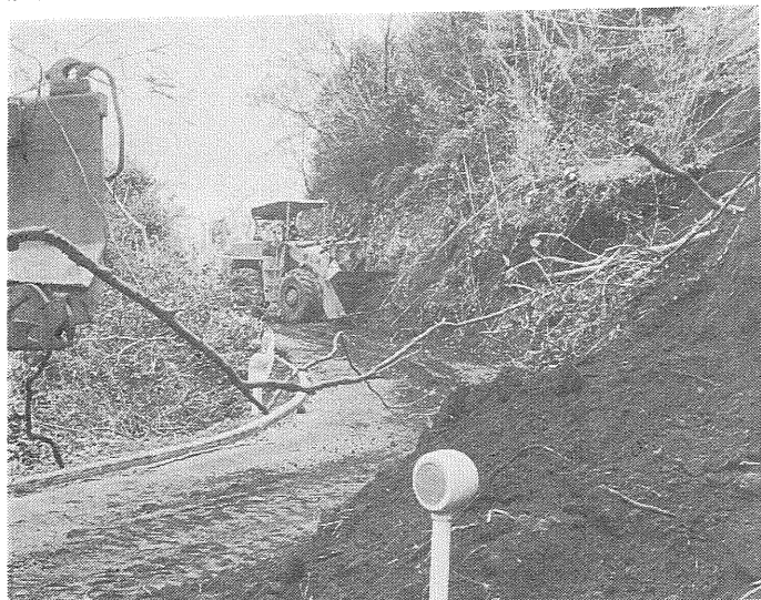
① 三根—登竜峠の道路。土砂の流出により一時不通となった
