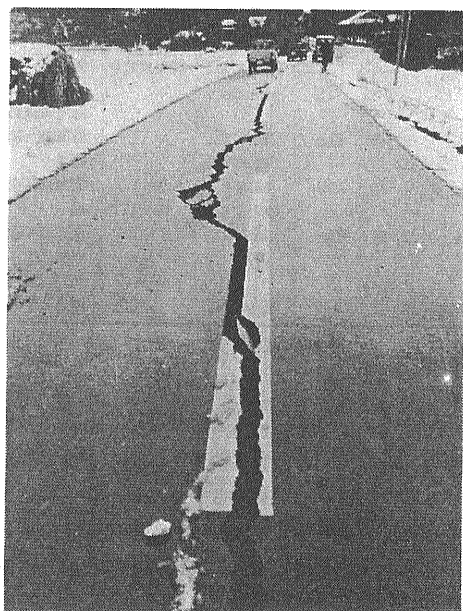
国道268号線線の地割れ(京町温泉南西) [宮崎県庁提供]
