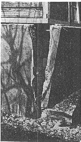
国鉄京町職員宿泊所の浴場の損傷
