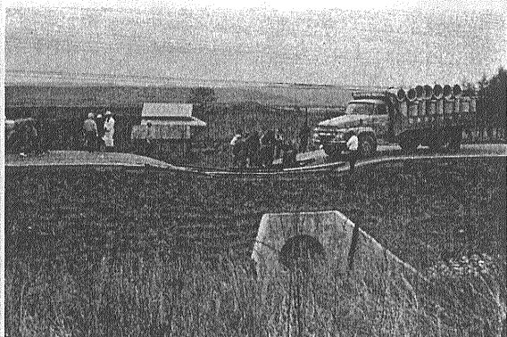
23 路面の沈下現象 この現象はほとんど路面下に高圧ヒューム管の入 っているところにみられた この場合高圧ヒューム管はほとんど 影響を受けていない 国道38号線 豊頃付近 (帯広開発建設部提 供)
