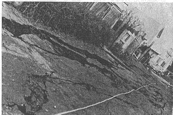
9 住宅街に生じた地割れ 車の通行が不能となった 静内町(静内町提供)
