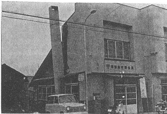
8 破損した集合煙突 浦河町堺町郵便局(浦河町提供)
