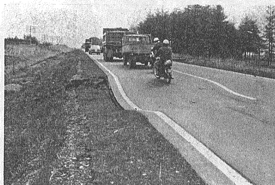
22 国道38号線にみられる地盤沈下現象 十勝郡豊頃付近 (帯広開発建 設部提供)
