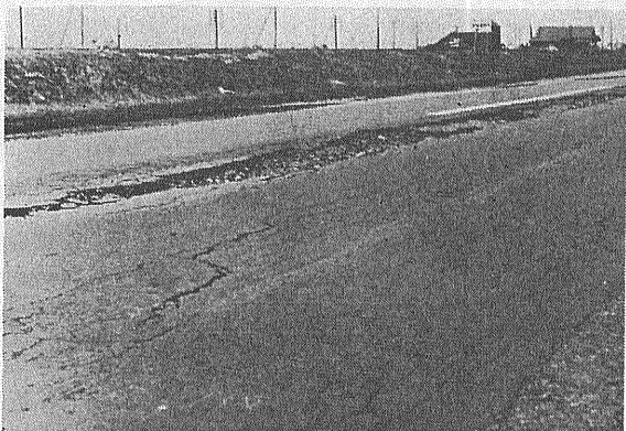
32 国道36号線に生じた亀裂 苫小牧市錦岡付近
