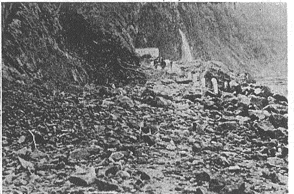
6 崩くずれ、急峻な海食崖の下を通る道路ではいたるところで崖くずれがみられた 恵山海岸 (函館開発建設部提供)
