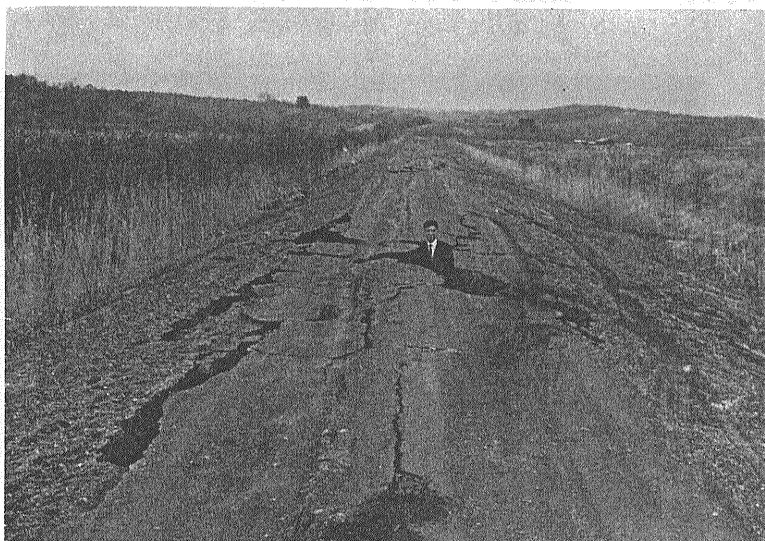
12 十勝川築堤にみられた 大人がすっぽり入る地割れ 豊頃町大津(帯広開発建設部提供)
