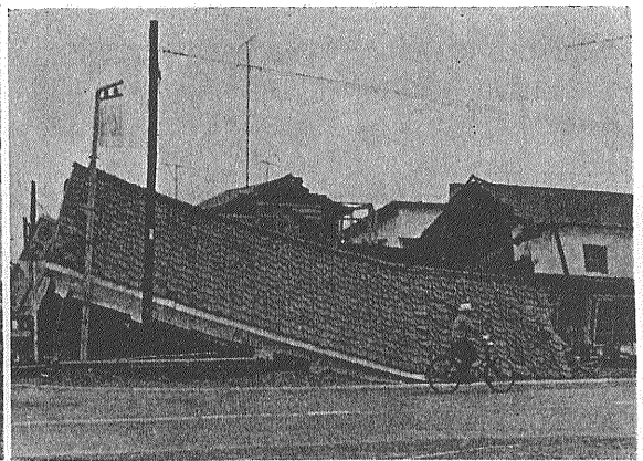
4 倒壊した浦河町萩伏の商店 この商店は元浦川の沖積地にある (浦河町提供)
