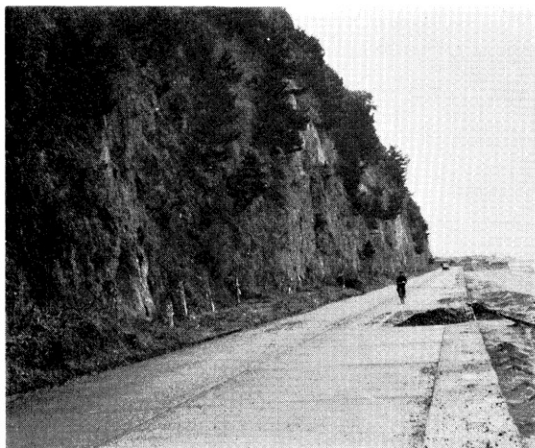
喜入海岸に連なるシラス（二次堆積軽石層）の崖 崖は垂直に切取っておいた方が崩れがたいといわれている これはシラスの上に新期ロームなどの不透水層が載っているためである
