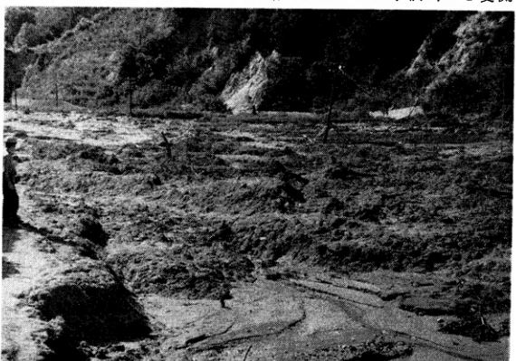
⑧ 松川町生田地区の風化花崗岩の崩壊により水田は完全に埋没した
