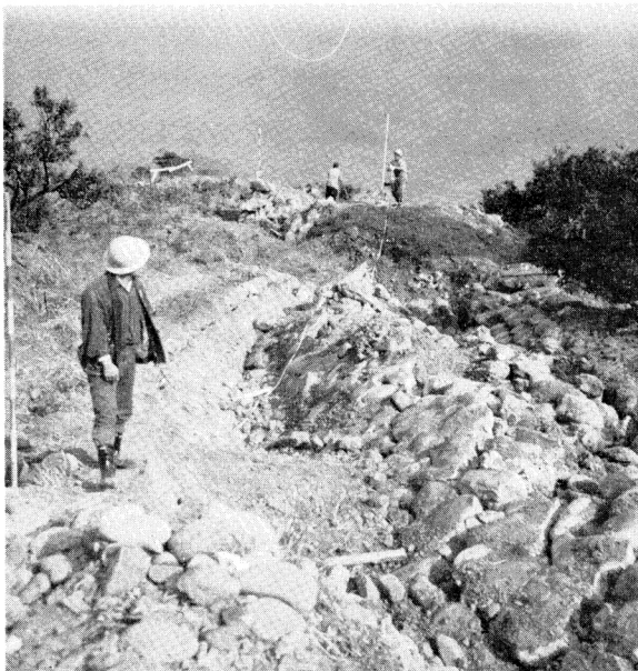
排水路（中之沢）の崩壊
