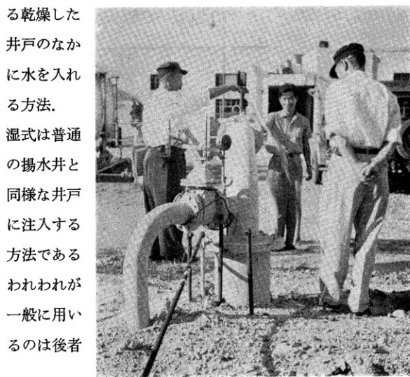
圧入専用井 井戸の周りの細いパイプはセメントグラウティング用のもの
