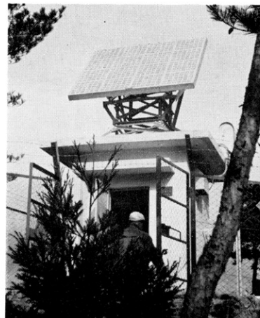
屋上にセットされた太陽電池 (写真2葉は日本電気KK提供)
