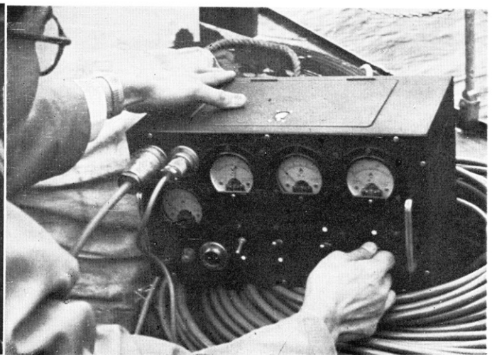
船上で遠隔制御装置(電気制御盤)で操作中
