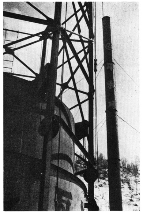
坑外ガスタンク
