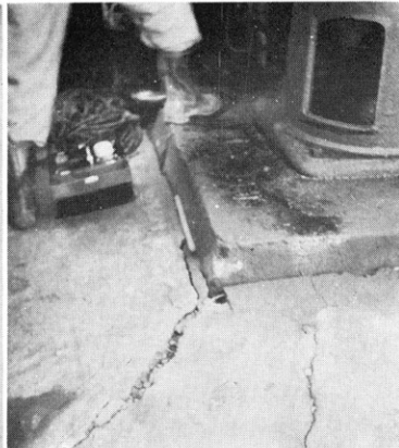
井戸側管の抜け上がりがコンクリート床のため抑制された結果亀裂の生じたところ(これなどまだ上等の部類 墨田区某ゴム工場)
