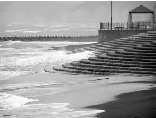
写真6 豊岬の休憩施設. 階段状護岸の下の浜は狭まり, 荒波が護岸に打ちつけている.
