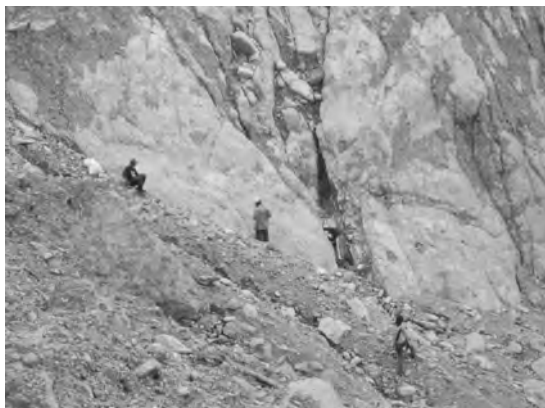
写真4 斜面中腹の崩壊斜面の遠景。岩盤に亀裂が多く走っている。第1図のB点にて撮影。
