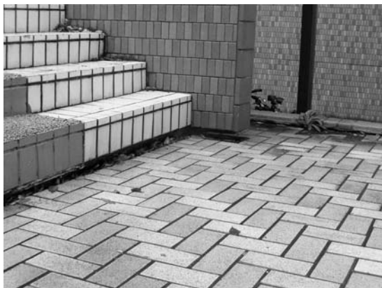
写真1 産総研構内の地盤沈下の様子。
