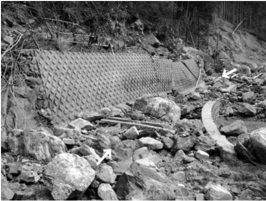
写真15 林道跡を示すコンクリート製の側壁。白矢印は、もとの林道跡を示しています。位置は第3図に示されています。
