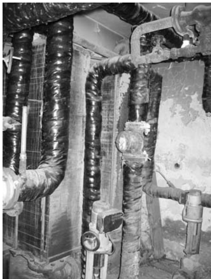
写真17 キュステンデルの老朽化した黒鉛熱交換器。
