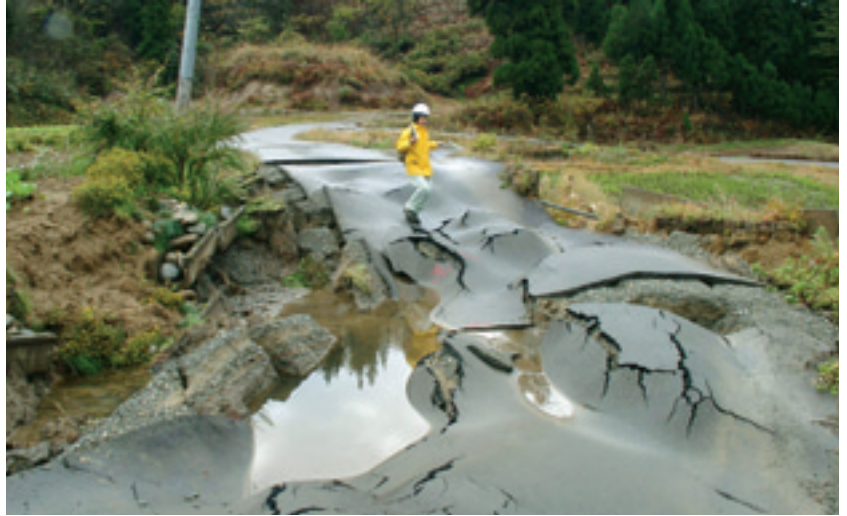
1. 地滑りにより変形した道路(川口町田麦山地区)。
