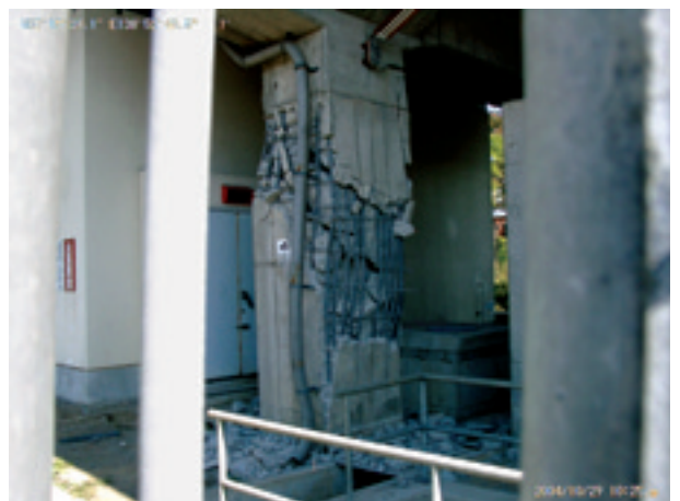
5. 剪断破壊した新幹線高架橋の橋脚。この周辺では耐震補強が未実施であった(川口町和南津地区)。
