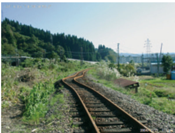
4. 変形した線路(川口町川口地区)。
