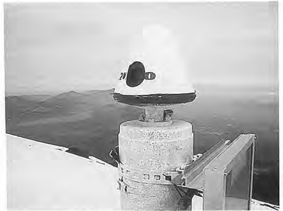
第19図 風で飛ばされた小石が当たって破損したレドーム、御殿場口六合目観測点(GST)。
